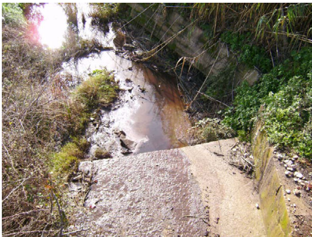
Εικόνα 9.5. Νερά ρυπασμένα με απόβλητα ελαιοτριβείων στη θέση Αγ. Θωμάς (Δεκέμβριος 2008 - φωτογραφία από τη γέφυρα δίπλα στο ελαιοτριβείο).
