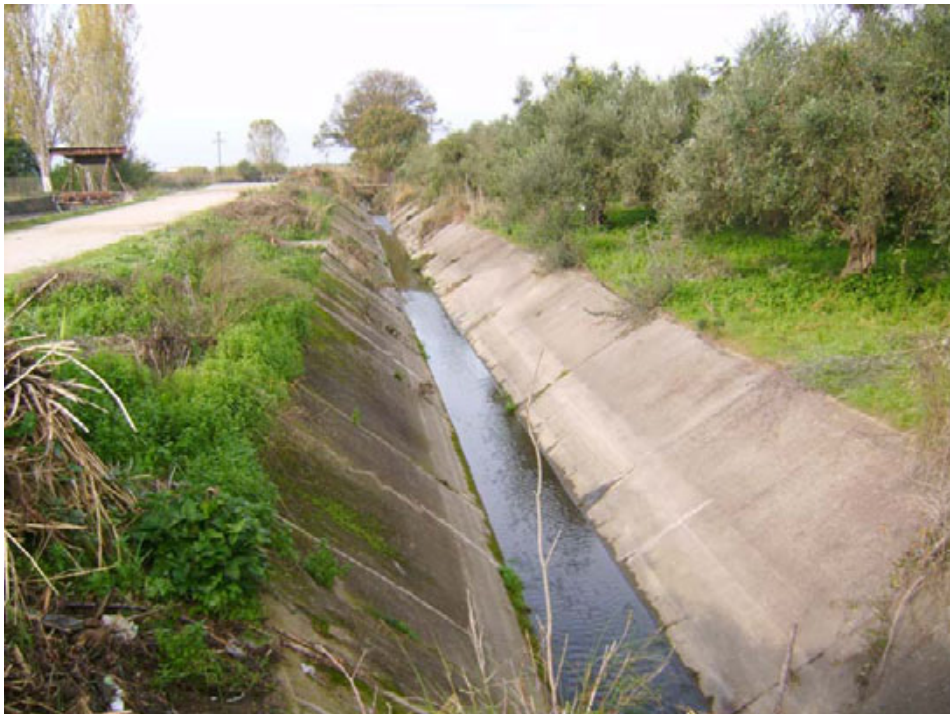
Εικόνα 2.1. Επάνω : Άποψη του κεντρικού αρδευτικού καναλιού που υπάρχει στο σταθμό Α. Κάτω : Παροχέτευση νερού από το κεντρικό αρδευτικό κανάλι σε μικρότερο που καταλήγει στην αύλακα.
